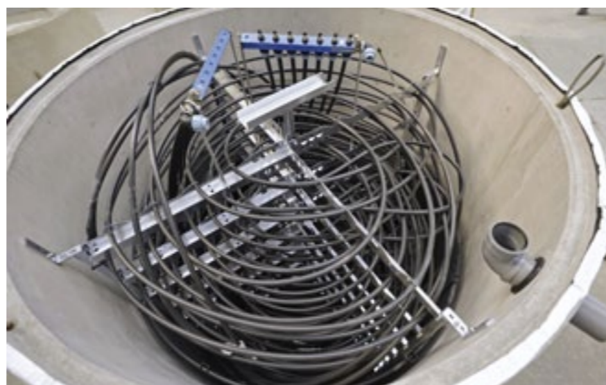
Zbiornik lodu – widok wnętrza
