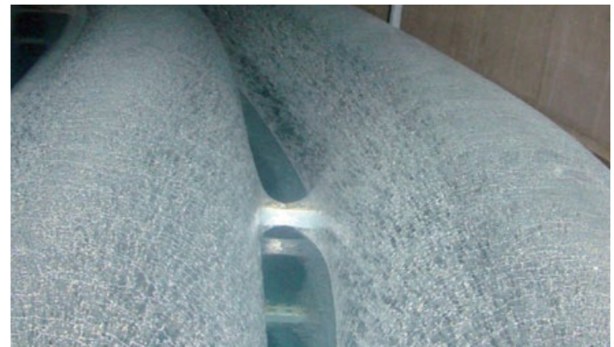
Oblodzenie wężownic w zasobniku lodu
