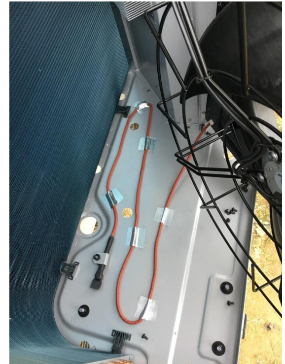
Zdj. Przewód ogrzewania wanny kondensatu.
