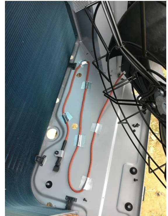
Zdj. Przewód ogrzewania wanny kondensatu.
