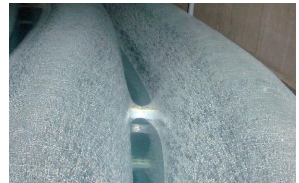
Zdj. Oblodzenie wężownic w zasobniku lodu.
