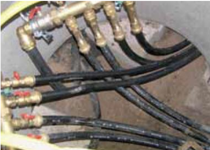
Zdj. Studnia rozdzielaczowa
