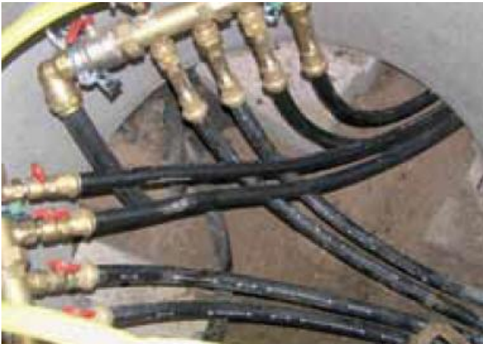
Zdj. Studnia rozdzielaczowa
