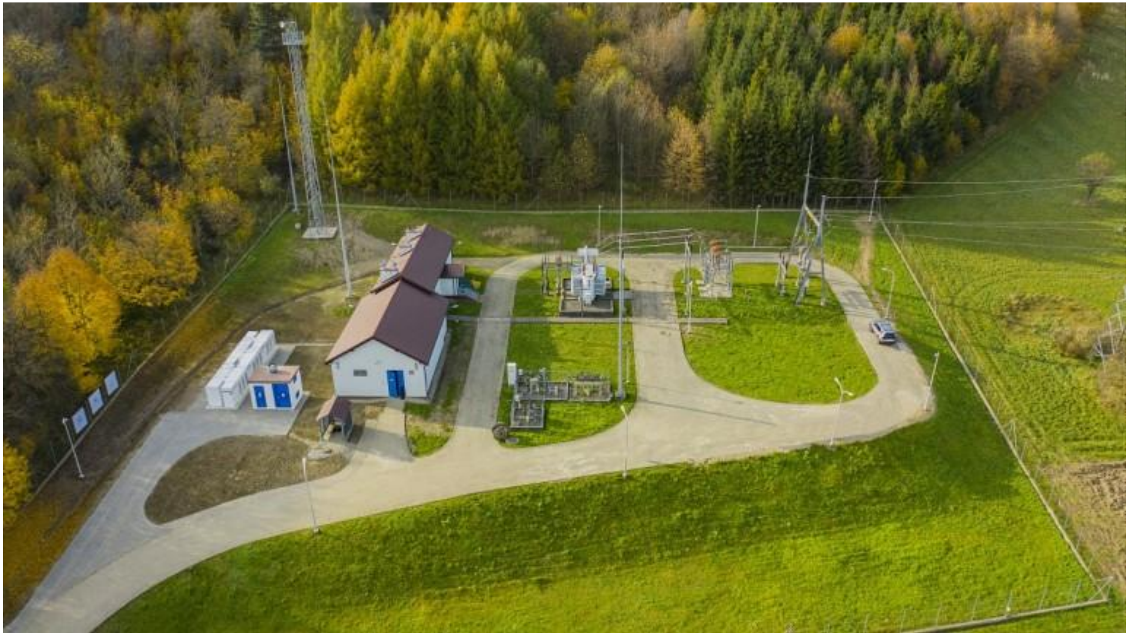
Magazyn energii o pojemności 4,2MWh i mocy 2,1MW, Rzepedź na Podkarpaciu, źródło: PGE
