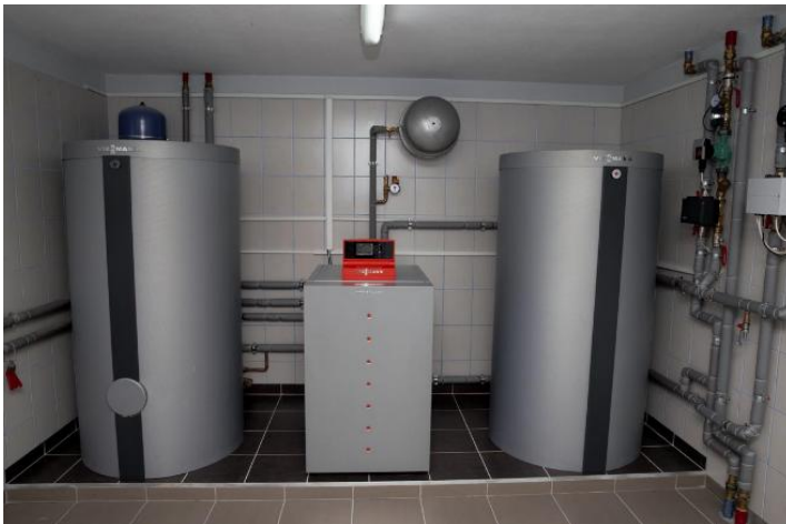
Zdj. Kotłownia z Vitocal 300-G (typ BW)
